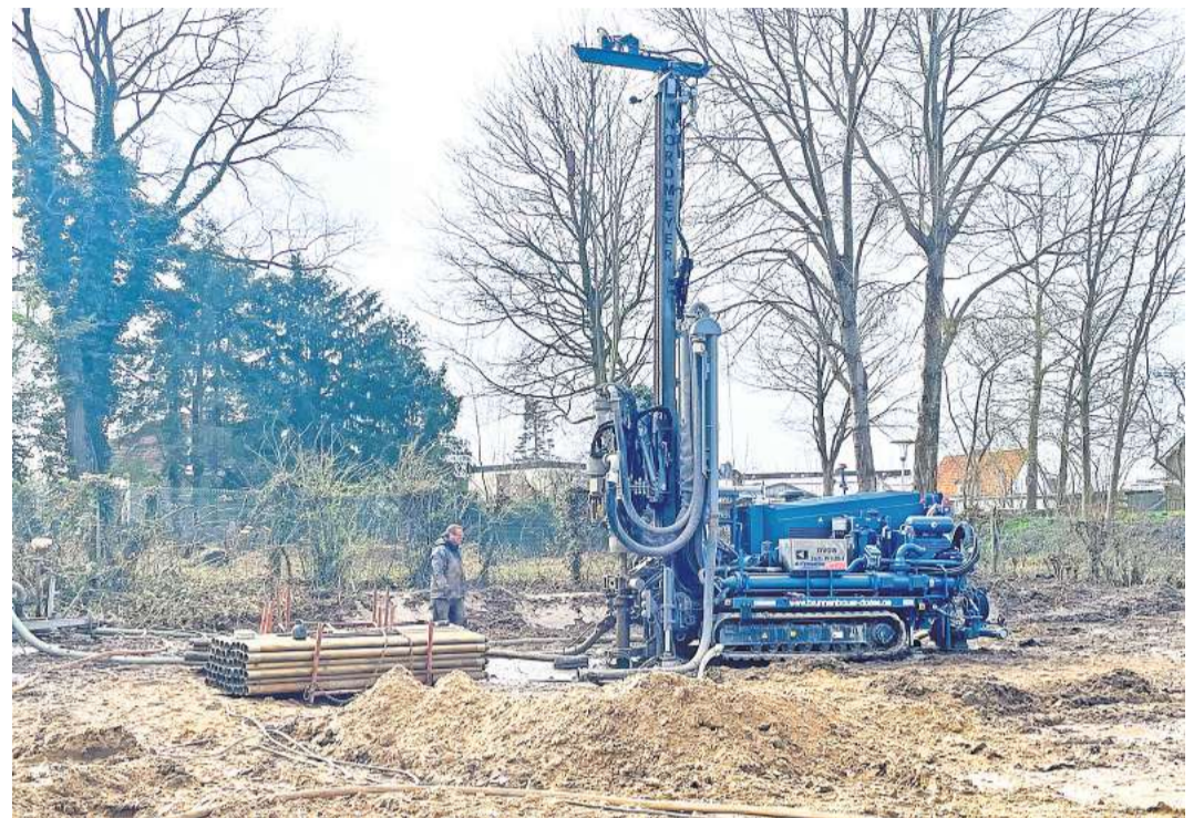
Die letzten Bohrungen für Geothermie auf dem Grandplatz Kronshagen liefen im März.
