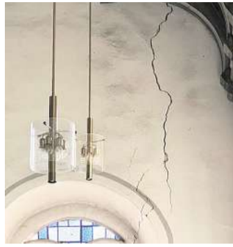
In der Nikolaikirche in Plön sind die Risse im Mauerwerk deutlich sichtbar.
