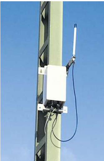
Über Antennen wie diese werden die LoRaWAN-Daten übertragen. FOTO: SH NETZ
